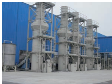
(b) 碱液淋洗塔
