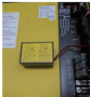
图3 设备系统外部稳压器电池组位置
