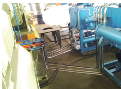
图2 调试中的液压控制系统
