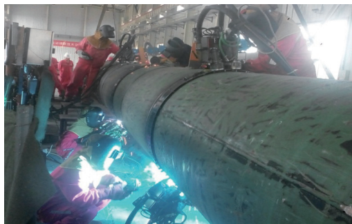
图16 焊接技术中心使用现场
