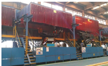
图14 移动伸缩式工作间焊烟除尘应用实例
