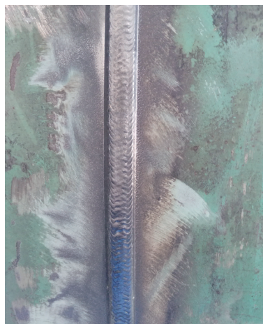
图1 焊缝条状气孔
