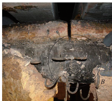
图2 沿两滑块间隙开裂
