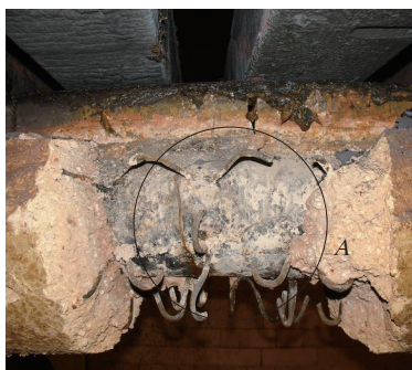
图1 沿滑块止裂孔处开裂
