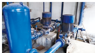
图1 水泵房冷却水池
