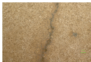
(b) 裂纹顶端
