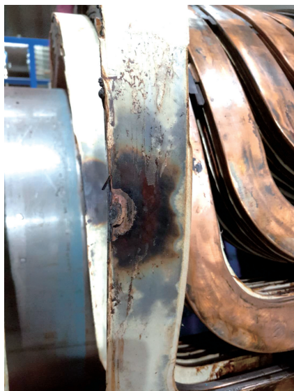
图7 内环6 # 线圈第三匝表面放电痕迹
