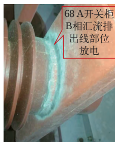
图3 10 kV 68 A开关柜所发现放电点
