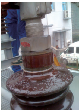
图6 10 kV B相套管渗油
