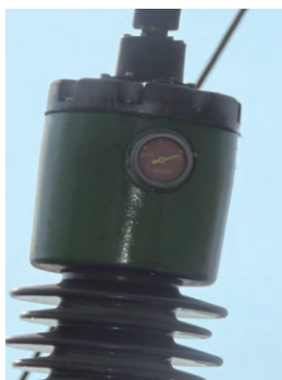
图1 110 kV B相套管头部渗油
