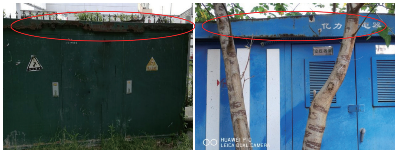
图1 室外的两个箱式变电站锈蚀的外壳
