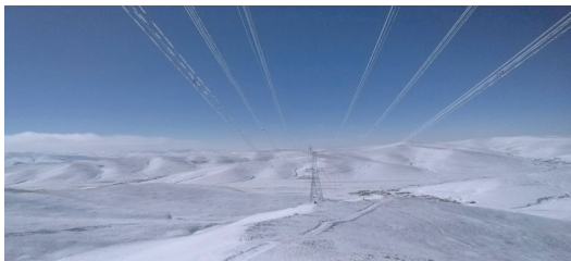
图1 坝上地区输电通道运维环境
