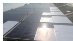
(a) 光伏发电系统实物平台
