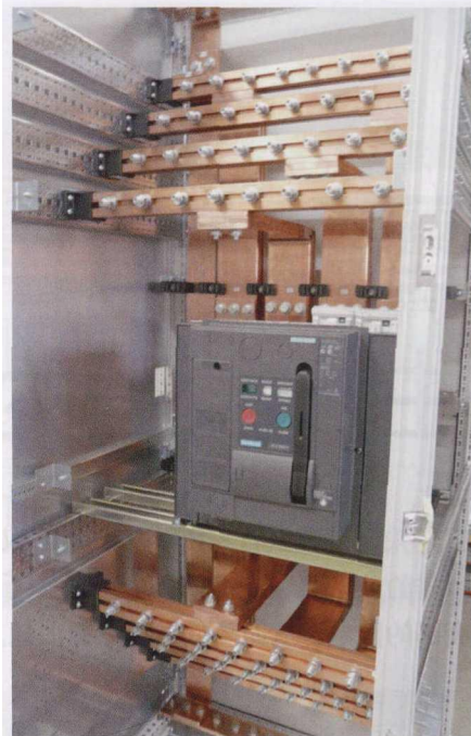
图 3 为了构建高功率和强电流配电设备，汉萨同盟电力解决方案有限公司（HPS）在配电设备中使用了相当多的铜材质件
