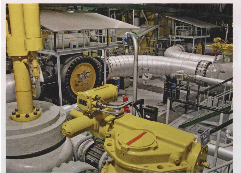
图 3 如图中所示，设备共有 22 个压缩机站
