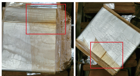
图12 224-9 C相CVT电容元件放电灼烧痕迹
