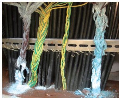
图1 变电站端子箱电缆屏蔽层发生严重腐蚀损坏
