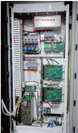
图5 电源现场安装位置
