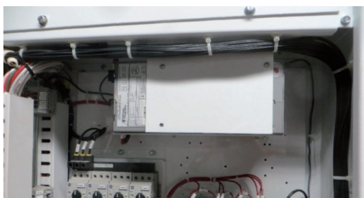
(a) 原开关电源安装位置
