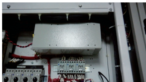
(b) 国产开关电源安装位置
