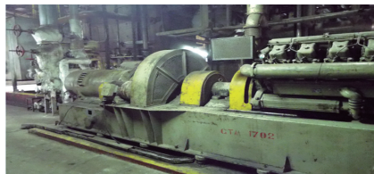
图1 事故发电现场图
