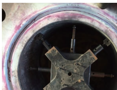
图3 人孔法兰环连接面裂纹
