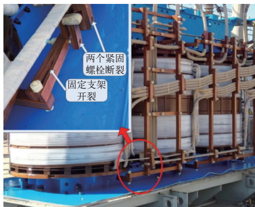
图1 支架损坏照片
