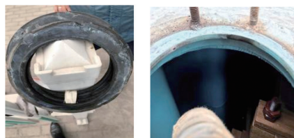
图4 损伤的套管胶垫及变压器壳体
