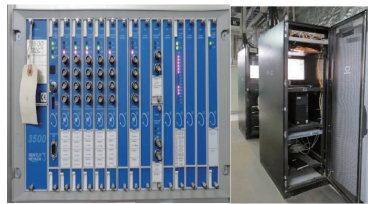
图2 现场硬件照片
