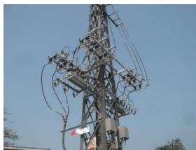
图7 已完成改进后的铜铝过渡线夹安装的110 kV宝月站10 kV宝塘线1#塔
