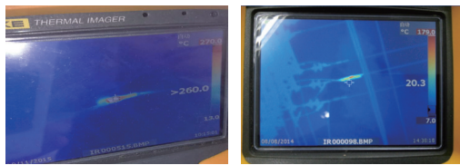
图3 110 kV宝月站刀开关发热 图4 110 kV宝月站10 kV弘声线并沟线夹发热
