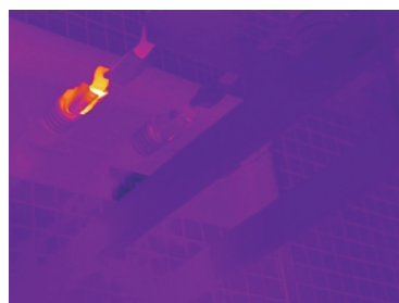
图1 10 kV穿墙套管红外成像图
