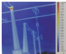
图3 500 kV罐式断路器接线头异常发热
