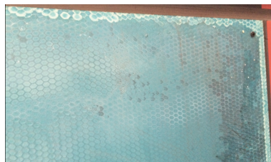
图 6 蜂窝芯内渗水情况
