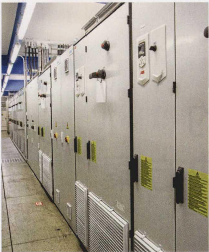
图 2 Uelzen 工厂中摆放的 ACS880-17 型变频器机柜
