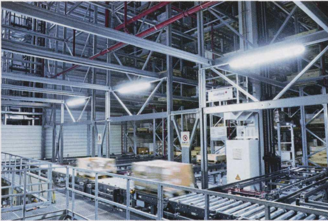
图 2 Symbiolog 公司新的物流中心：全自动的 HRL 托盘高架立体库共有 9 100 个托盘架口
