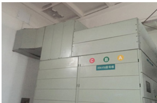
图2 2 # 主变压器302开关柜穿墙套管
