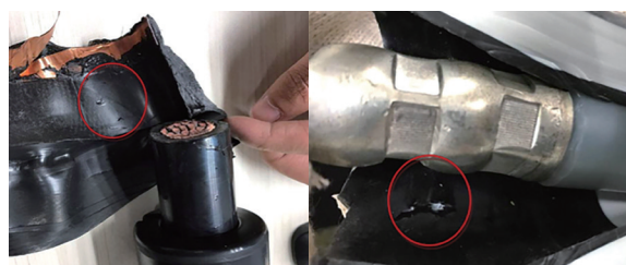
图6 电缆接头解体图
