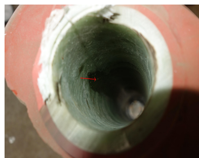
(b) 避雷器内壁水痕照片
