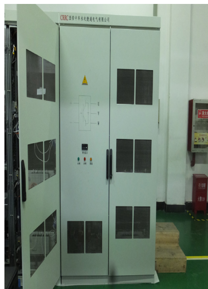
图10 能馈变流器样机照片
