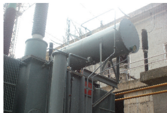
图3 2#主变压器油枕
