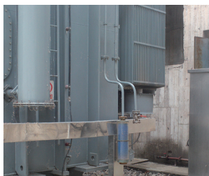
图2 2#主变压器呼吸器图
