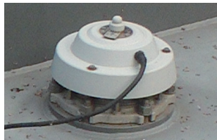
图1 2#主变压器压力释放阀
