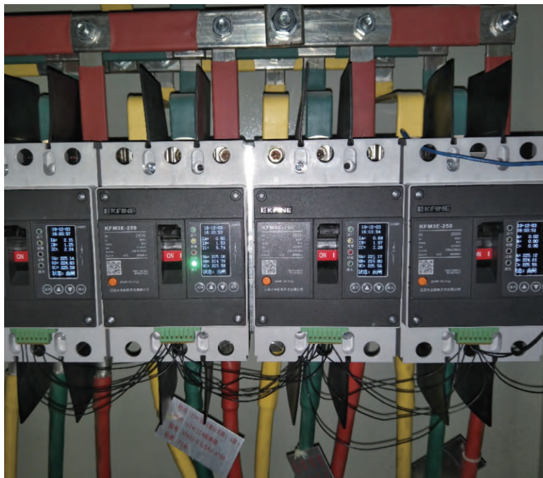
图4 智能低压断路器应用现场
