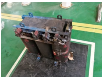
图1 故障变压器外观图
