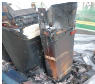
图3 故障变压器A相绕组图
