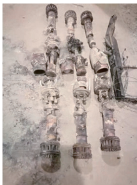
图1 212开关柜烧毁、真空泡碎裂
