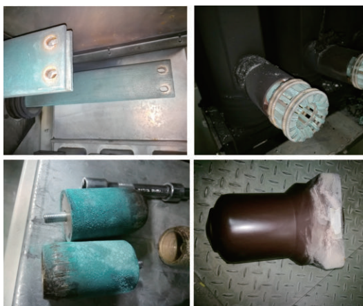
图2 10 kV I 段母线、各出线设备严重受潮
