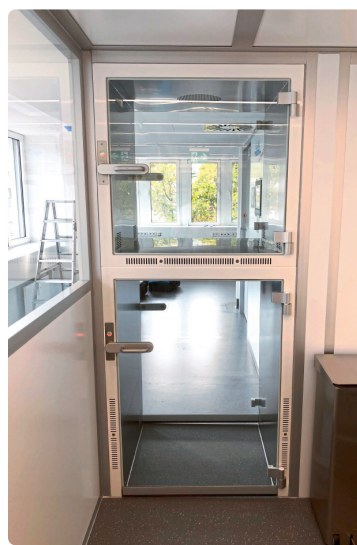
图 2 高于地面的物料称重系统确保了原材料安全地进入洁净室
