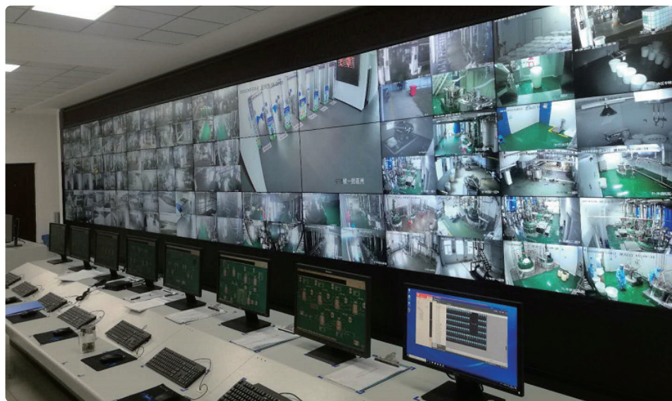
图 3 某原料药企业控制室局部
