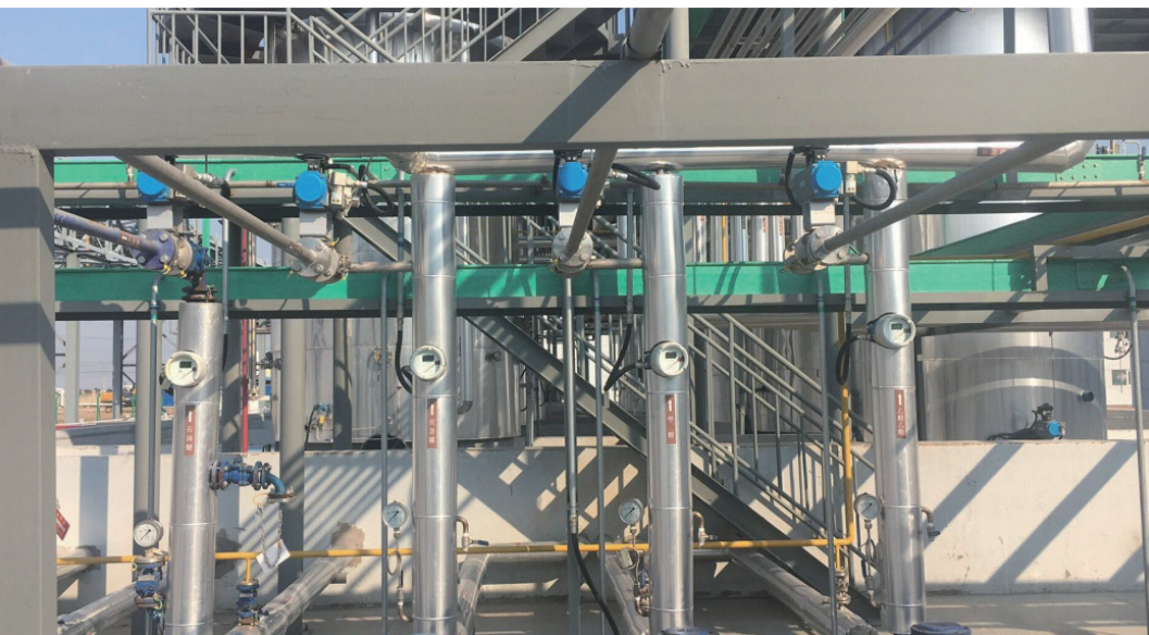
图4 某原料药企业溶媒精馏自控系统局部
