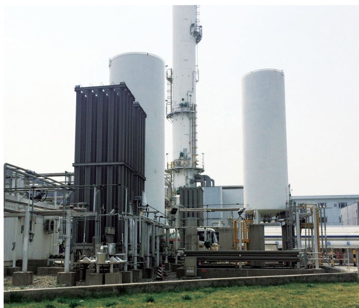
液氮制冷罐区
