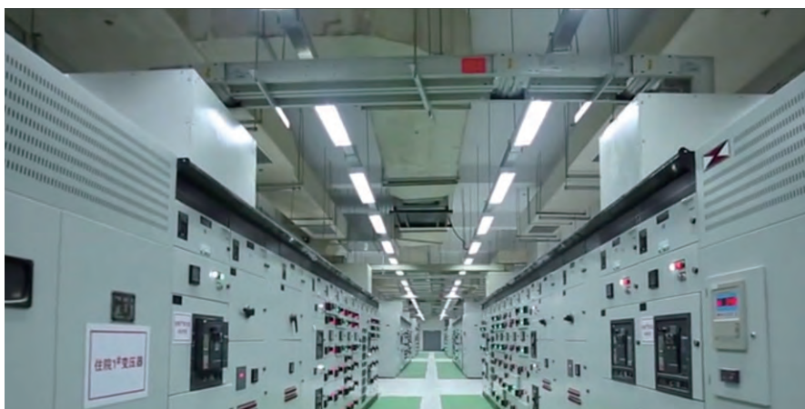
施耐德电气为医院提供智能配电解决方案，对庞大复杂的供配电系统进行智能化管理
