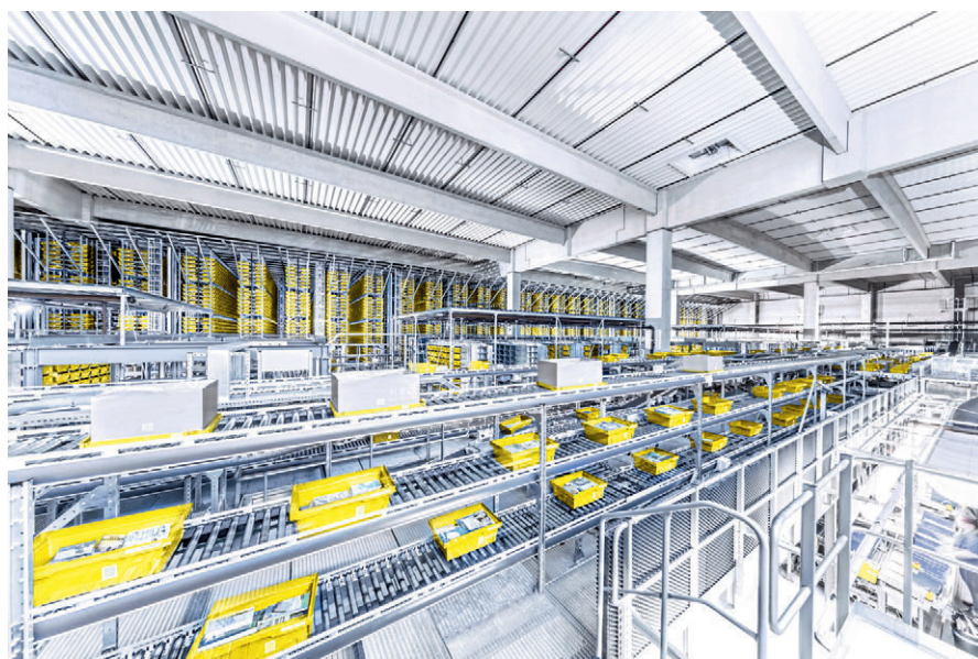
图 3 KNV 公司的配电中心安装的纸质包装箱和周转箱运输设备的总长度为 21 km
