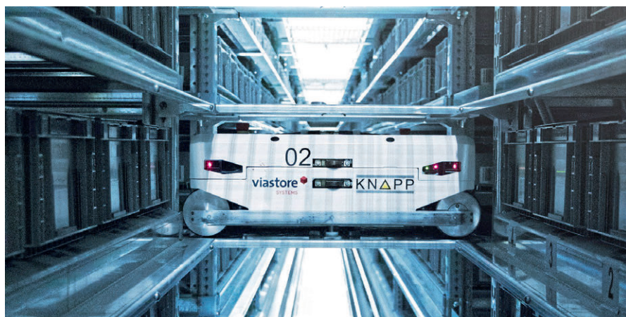
图 2 在 Eisele 公司新建的物流仓库中, 穿梭车输送系统提供了 17 280 个周转箱的存储架口; 可以非常简单地扩建货架系统, 提供仓库的仓储容量
