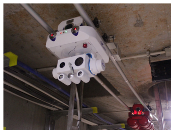
图9 电缆隧道架空式巡检机器人
