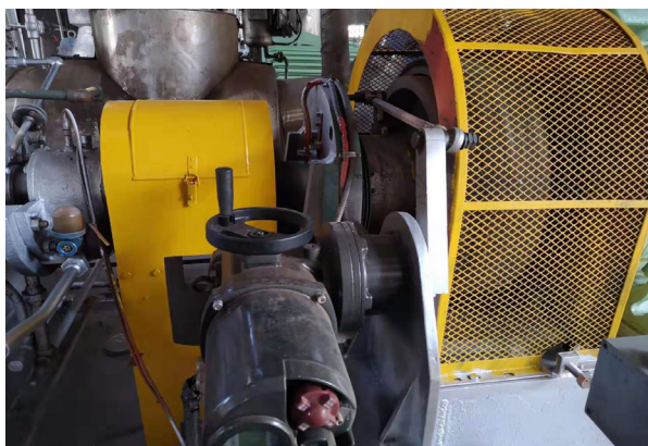
图4 改造后设备安装图片
