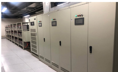
图4 集中UPS系统现场排布图
