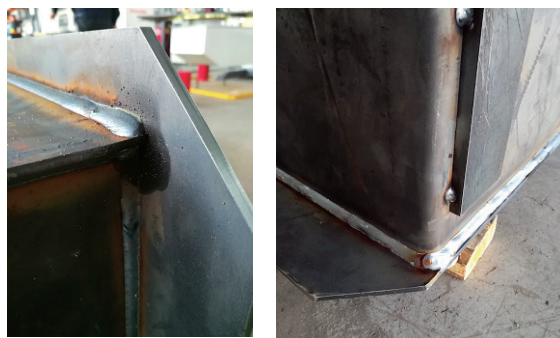
图6 焊接试验漏油改进前后对比
