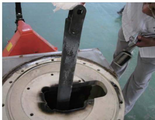
(a) 274开关绝缘拉杆表面及高电位放电点
