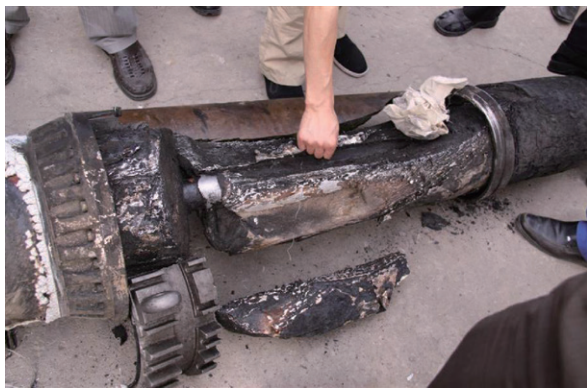
图6 3#变压器 500 kV 套管故障
