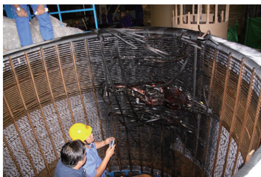
图 7 3 # 变压器高压绕组故障情况
